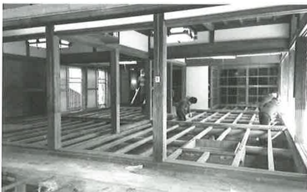
屋敷内の泥出し
